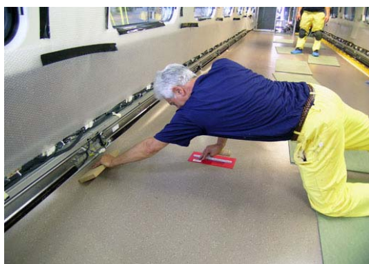
7. Srotolare il telo sulla colla e pressare con spatola assicurandosi della perfetta aderenza.
